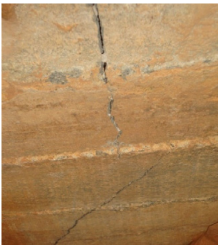
Figura 1.8 – Fissuração em lateral de bloco de concreto. Fonte: Hasparyk et al. , 2016.
