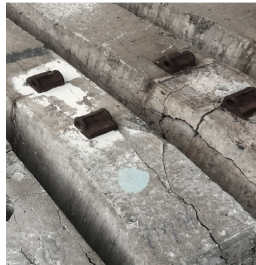
Figura 1.7 – Dormentes fissurados – Brasil. Fonte: Selmo C. Kuperman.
