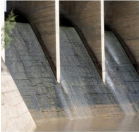
Figura 1.4 – Vertedouro apresentando quadro fissuratório por DEF. Fonte: Blanco et al. , 2019.
