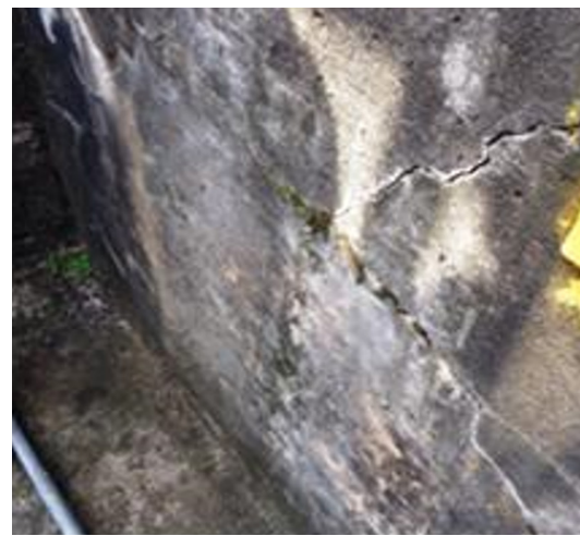
Figura 1.9 – Fissuras por DEF e RAS em estrutura de concreto de UHE. Fonte: Selmo C. Kuperman.
