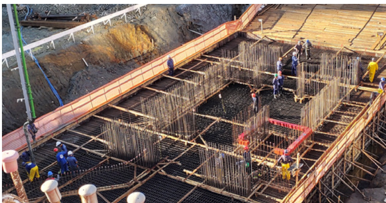
Figura 7.17 – Concretagem do bloco de fundação (altura de 4,00 m e volume aproximado de 1.000 m 3 ). Fonte: DESEK.
