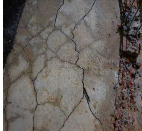
Figura 1.5 – Detalhe de fissuração mapeada em bloco de fundação de prédio devido apenas à DEF, no Brasil. Fonte: Selmo C. Kuperman.
