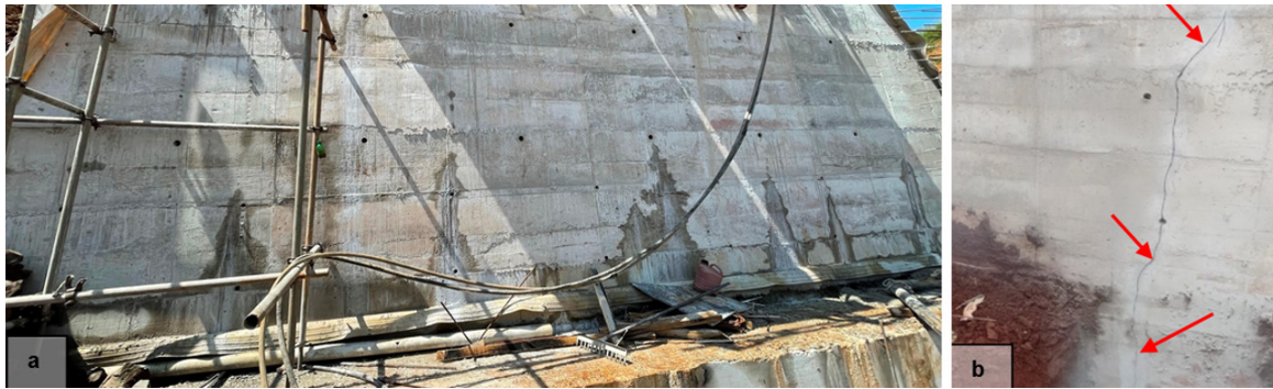
Figura 1.15 – a) Vista de várias fissuras verticais, após teste com água; b) Detalhe de fissura antes do tratamento com injeção de resina epóxi.
