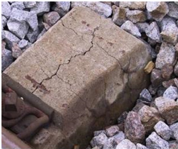
Figura 1.6 – Dormente fissurado devido à DEF – Portugal. Fonte: Silva; Gonçalves, 2008.
