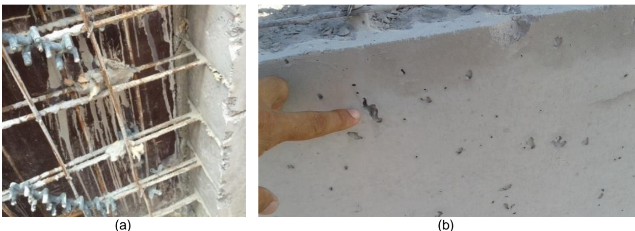
Figura 5 – (a) Fôrmas previamente a concretagem sem limpeza adequada e com restos de concreto aderidos e (b) buracos no concreto desmoldado decorrentes do mau estado da fôrma e provável perda de trabalhabilidade do concreto autoadensável (Arquivo Deseq, 2020)
