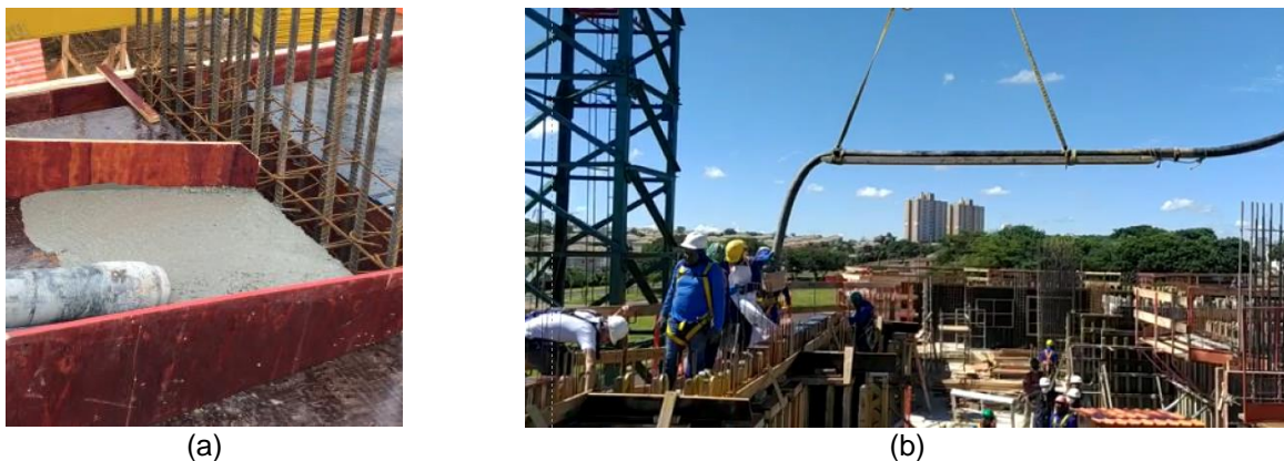
Figura 15 – Exemplos de aparatos adotados em obras: (a) mangote deitado em uma “rampa” para suavizar a queda do concreto em obra em São Paulo, SP e (b) aparato para reduzir a altura de queda do concreto em obra em Ribeirão Preto, SP (Arquivo Desek, 2022)
