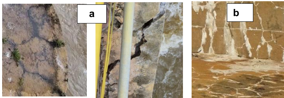
FIGURA 1 – a - Caso 1 - Pilares de vertedouro; b - Caso 2 - Muro de vertedouro de barragens no Brasil
