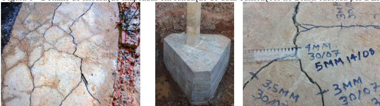
Figura 1 - Detalhe de fissuração mapeadas em fundação de duas edificações no Brasil causada por DEF
