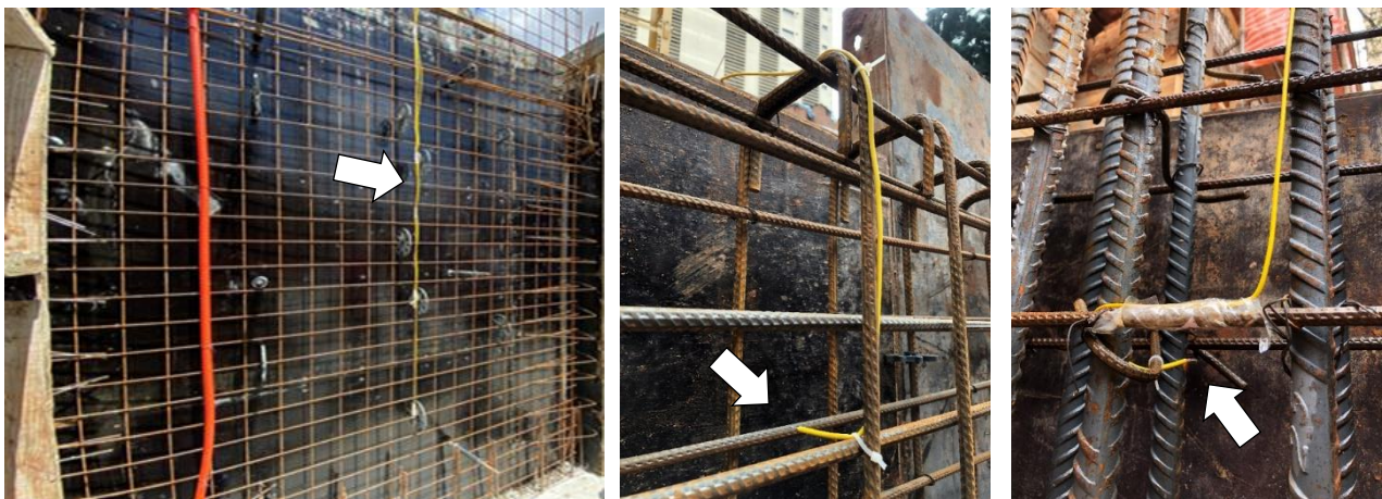
Figura 10 - Termopares instalados no pilar parede utilizado como protótipo. Expansão do Colégio Bandeirantes (Deseq & Falcão Bauer, 2021)
