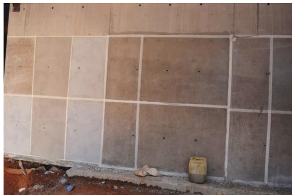
Figura 9 – Protótipo após a remoção das fôrmas, segmentado para testes de produtos de tratamento superficial. Expansão do Colégio Bandeirantes (Desek, 2021)
