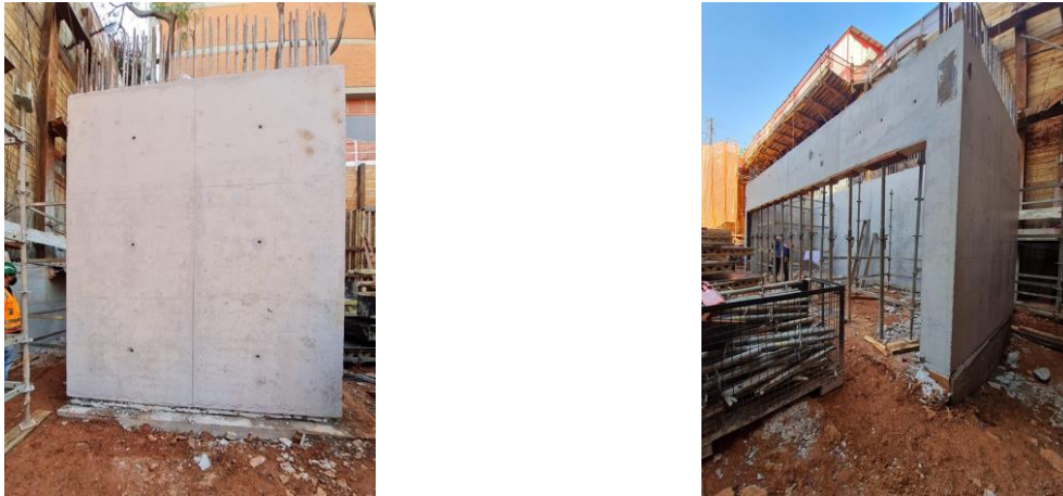
Figura 8 – Detalhe do protótipo após a remoção das fôrmas, com poucas imperfeições e bom acabamento superficial. Expansão do Colégio Bandeirantes (Desek, 2021)
