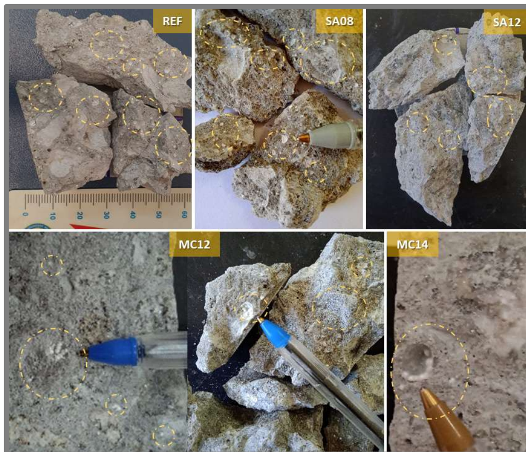
Figura 4 – Feições observadas por inspeção visual na porção interna dos concretos.
