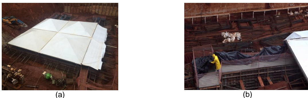
Figura 9 – (a) Estrutura para proteção do bloco contra a incidência de chuva; (b) plataforma de acesso e utilização de manta de plástico para proteção do concreto fresco durante a chuva
