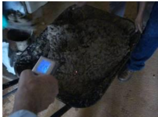
Figura 2. Medição da temperatura de lançamento do concreto através de termômetro digital previamente ao seu lançamento
