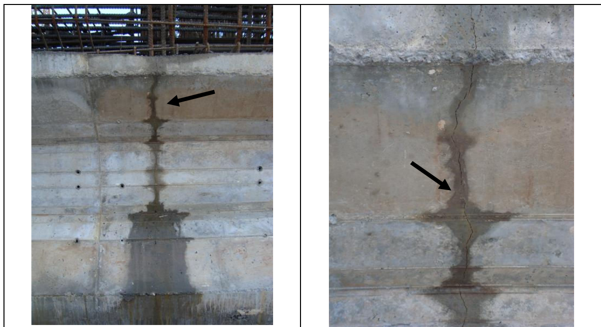
FIGURA 1 – Fissuras verificadas quando da visita à usina
