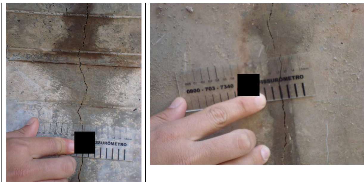
FIGURA 2 – Detalhe das fissuras. Notar fissuras de aproximadamente 0,8mm
