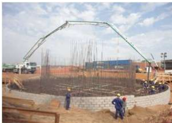
Figura 1 – Vista geral do bloco de fundação da base da chaminé – Notar fôrmas de alvenaria
