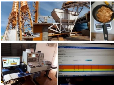
Figura 17 – Central de campo automatizada, com sensor de umidade, instalada no canteiro de obras. Agilidade no atendimento e acompanhamento das pesagens e ajustes na água de amassamento do traço em tempo real.
