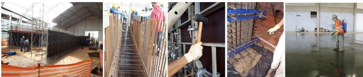
Figura 19 - Treinamento para equipes de forma, armação, lançamento e vibração do concreto em camadas com espessura controlada e aplicação de retardador de superfície para executar corte verde nas juntas de concretagens entre as placas de piso e paredes do túnel (gavetas) e agente de cura química.
